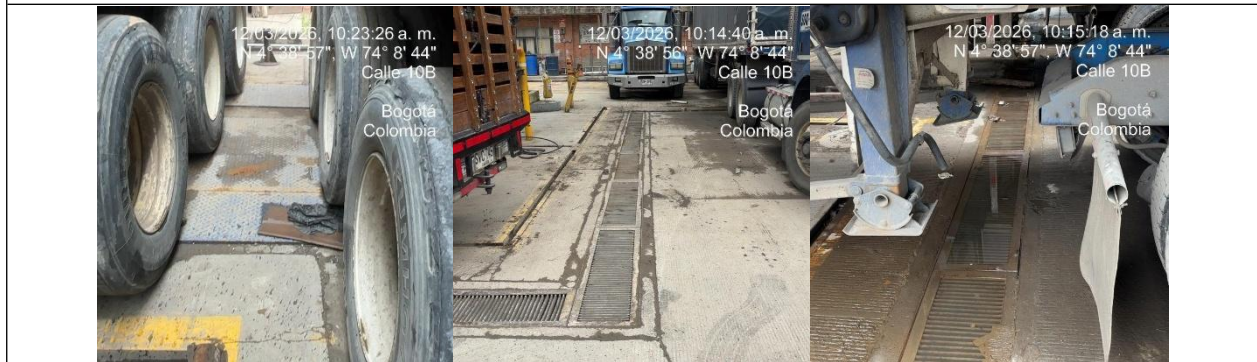
Foto 18. Trampa de grasas y rejillas perimetrales.
