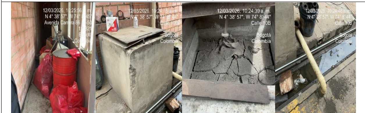
Foto 30. Cuarto Temporal RESPEL y Caseta de Lodos
